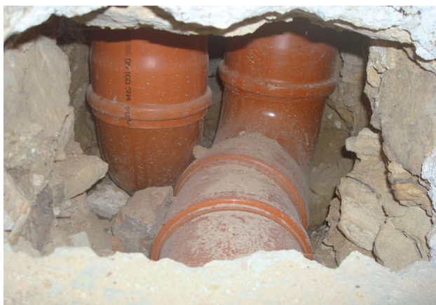
Detail poškození gelových injektáží
