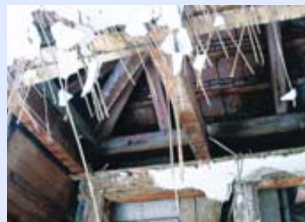
Nepřiměřené stavební úpravy podkrovní bývají často příčinou statických poruch
