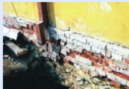
U starších objektů, kde mnohdy chybí drenáže a zpevněné základy, nedochází k přirozenému odtoku vody z podzákladů
