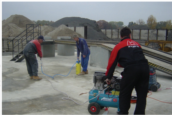
Mycí rampa v Českých Budějovicích, realizace firma ABASTAKO s.r.o.
